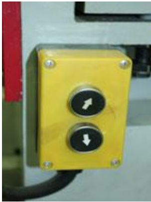
Управление подъемом/опусканием нижней траверсы на отдельном пульте
